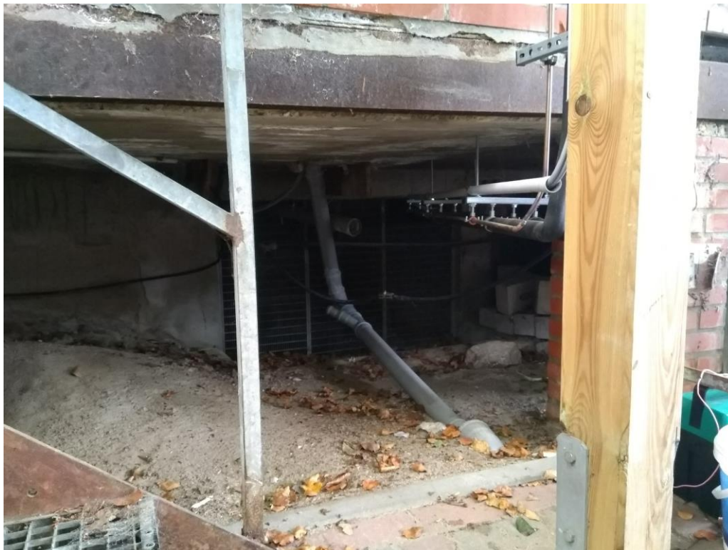
Abbildung 1: Ansicht haustechnische Anlage unterhalb der Laderampe
